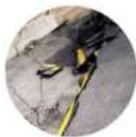
Деформации при землетрясениях
